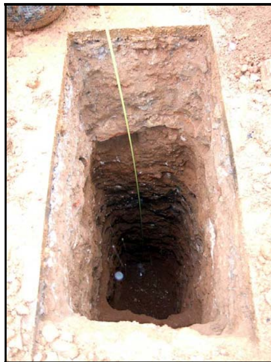
Fotografia 13: Cala a Plaça d'Urquinaona, sense serveis.
