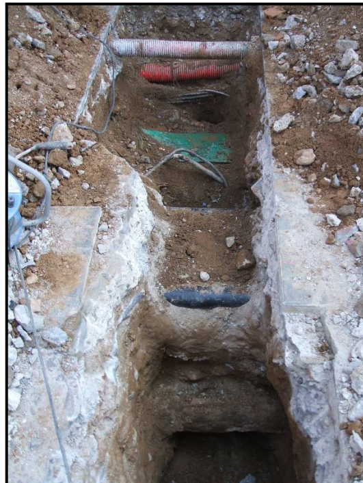
Fotografia 1: Sondeig a Plaça Catalunya amb Rivadeneyra, ple de serveis.
