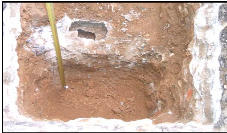
Fotografia 10: Canalització buida a la cala de carrer de Fontanella, 12b
